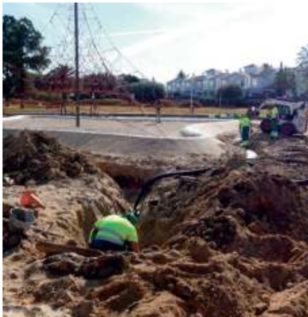
Sustitución de la red de drenaje del Parque Ballena de los Niños. ferior.
