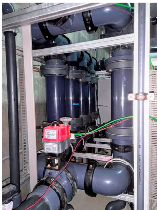
▲ Imagen 2. Equipo de tratamiento y control del agua regenerada
